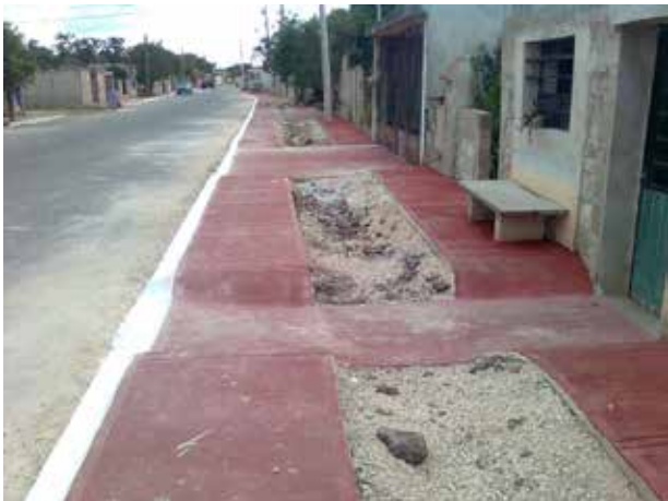
Construcción de banquetas y guarniciones en la Col. Francisco Villa Oriente, Mérida, Yuc. 2011 INCCOPY
